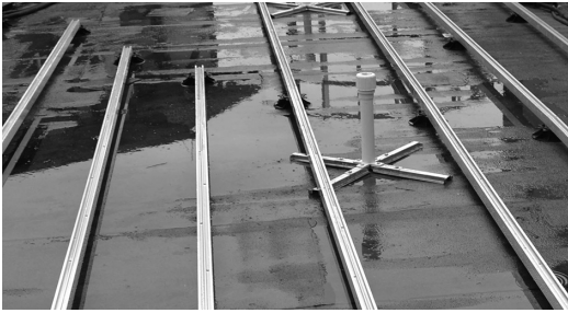
Bild 1. Wasserlachen auf einer Abdichtung einer Dachterrasse
