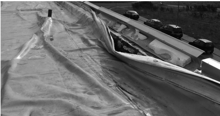
Bild 10. Nach einem Windergebnis mit Luftgeschwindigkeiten von 150 km/h wurde diese Dachabdichtung schwer beschädigt. Allerdings war der Dachaufbau fehlerhaft verklebt worden.
