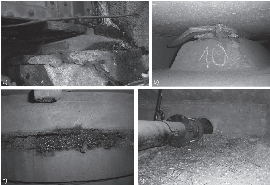
Bild 5. a) bis c) Beispiele für schadhafte Lager und Lagerpunkte, d) als Nistmöglichkeit genutzter Hohlraum einer Brücke mit Verschmutzungen durch Vogelkot und Nistmaterial (nach [13])
