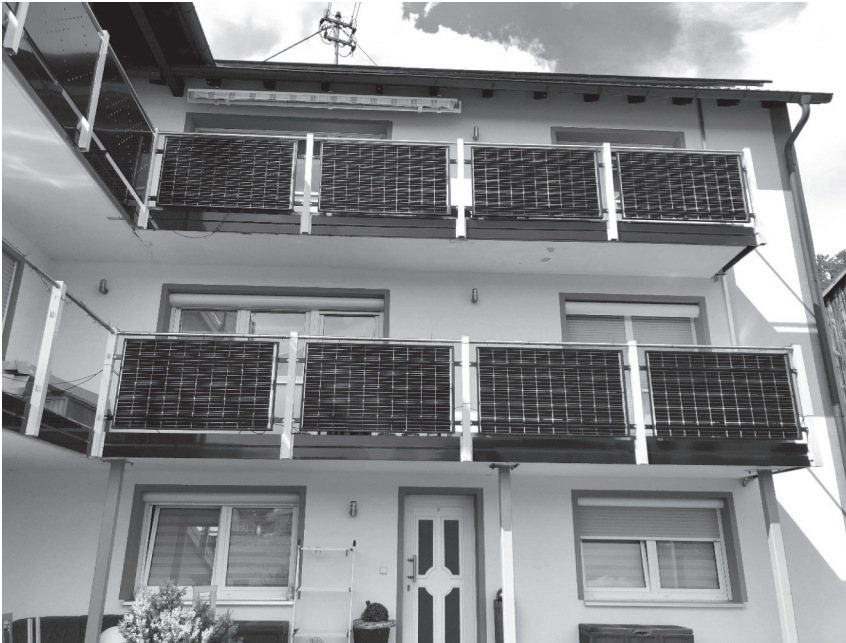
Abbildung 1.1: Mehrere Balkonkraftwerke (Copyright: Solarwatt)
