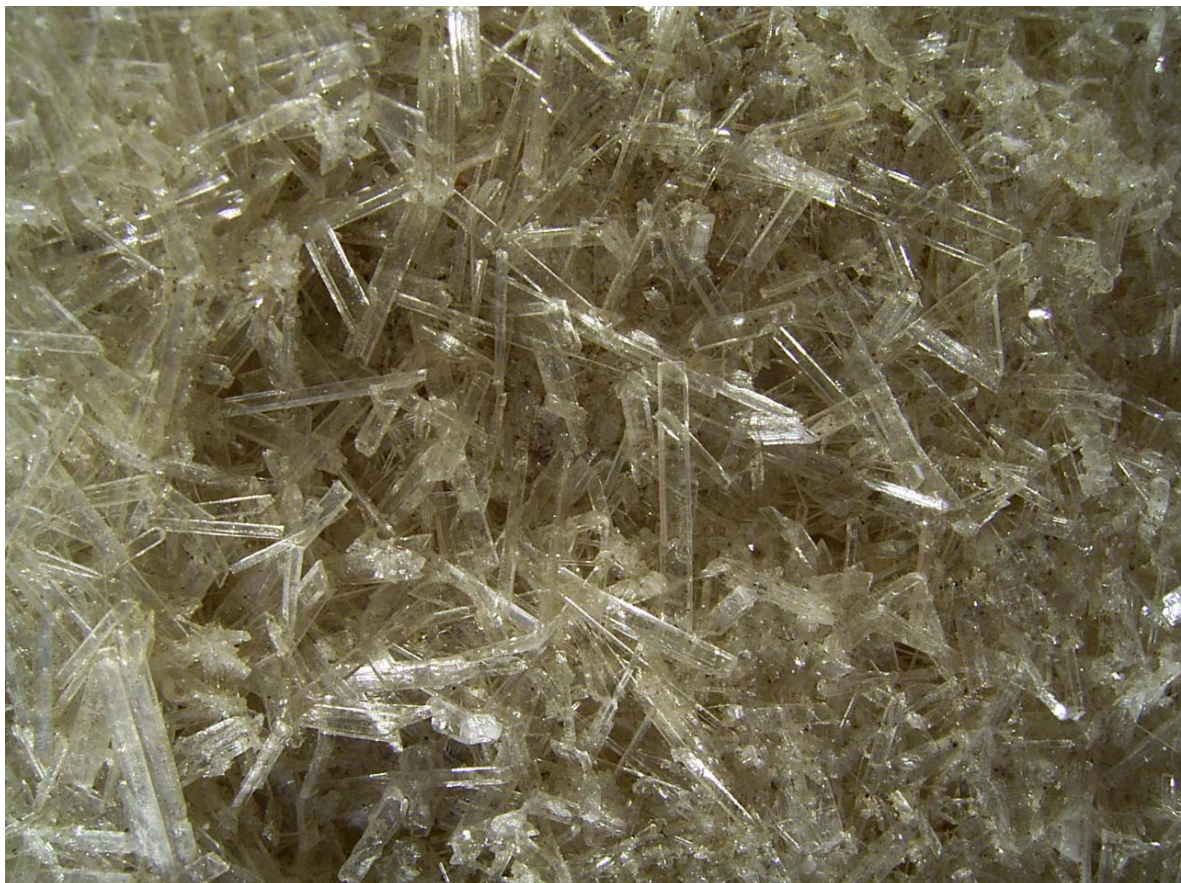
Bilder 4.4.4 L und M: Gips an der Außenwand einer Soleleitung, Bad Oeynhausen Bild L: 9 x 14 cm, Bild M: 2,7 x 4 cm
