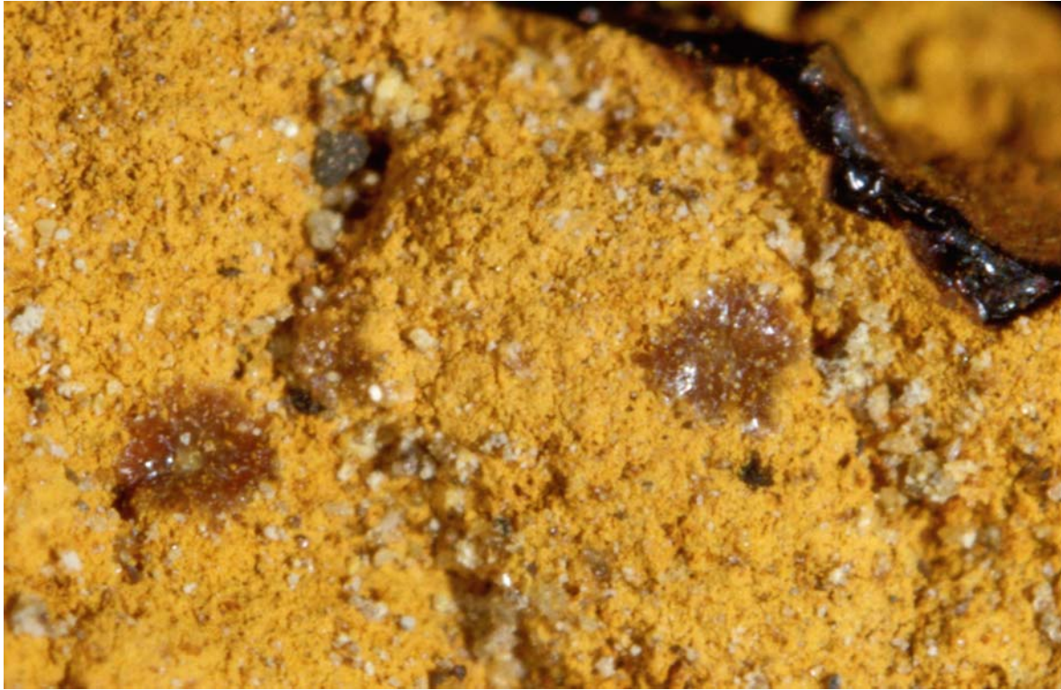
Bild 4.4.4 F: Zwei Gipsabscheidungen auf der Außenseite einer Korrosionspustel, DN 125, 1979, 2 x 3 mm.
