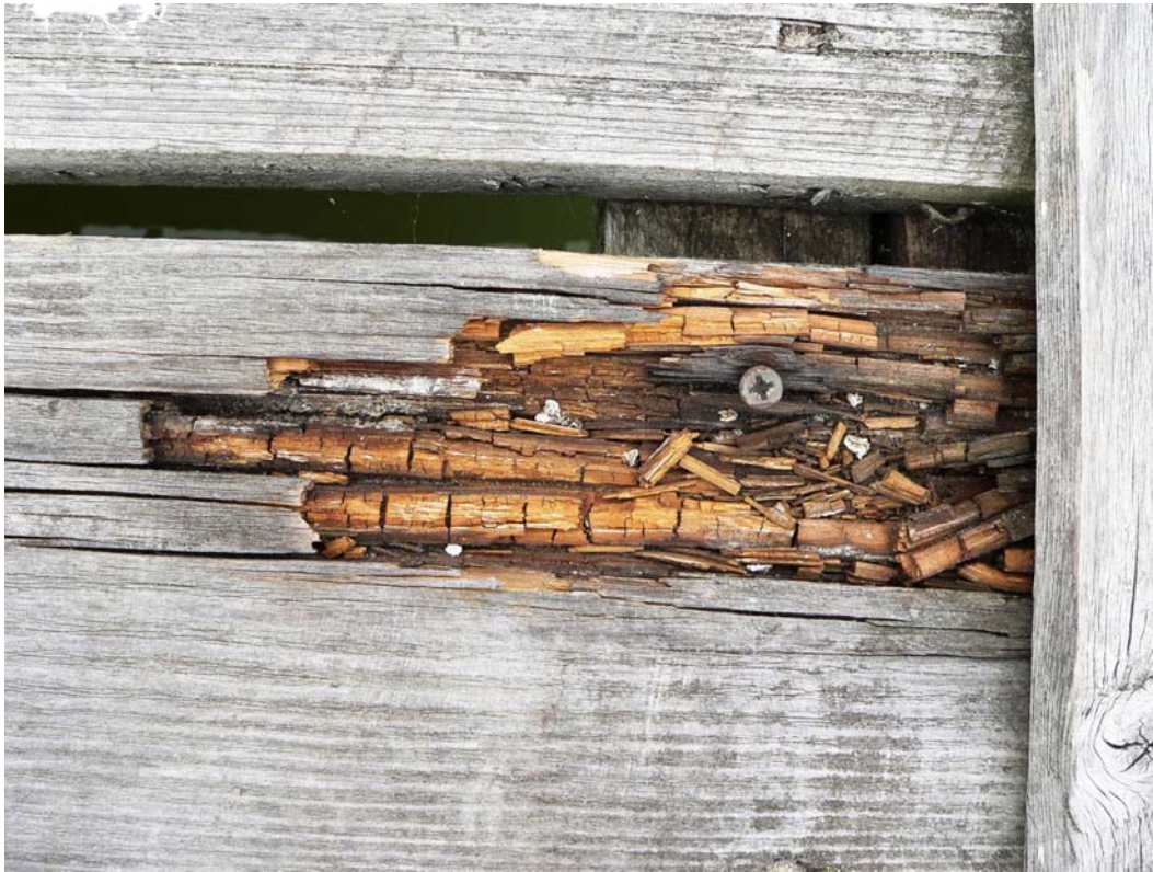
Bild 6.3.4 P: Morsche Stelle an einem Bootanlegesteg am Steinhuder Meer (2010)
