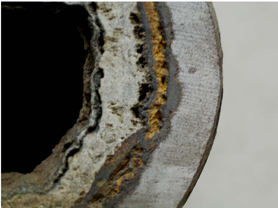
Bilder 7 J und K: Brasilianisches Graugussrohr DN 65 mit Korrosionsprodukten und Calcitabscheidung, September 1995
