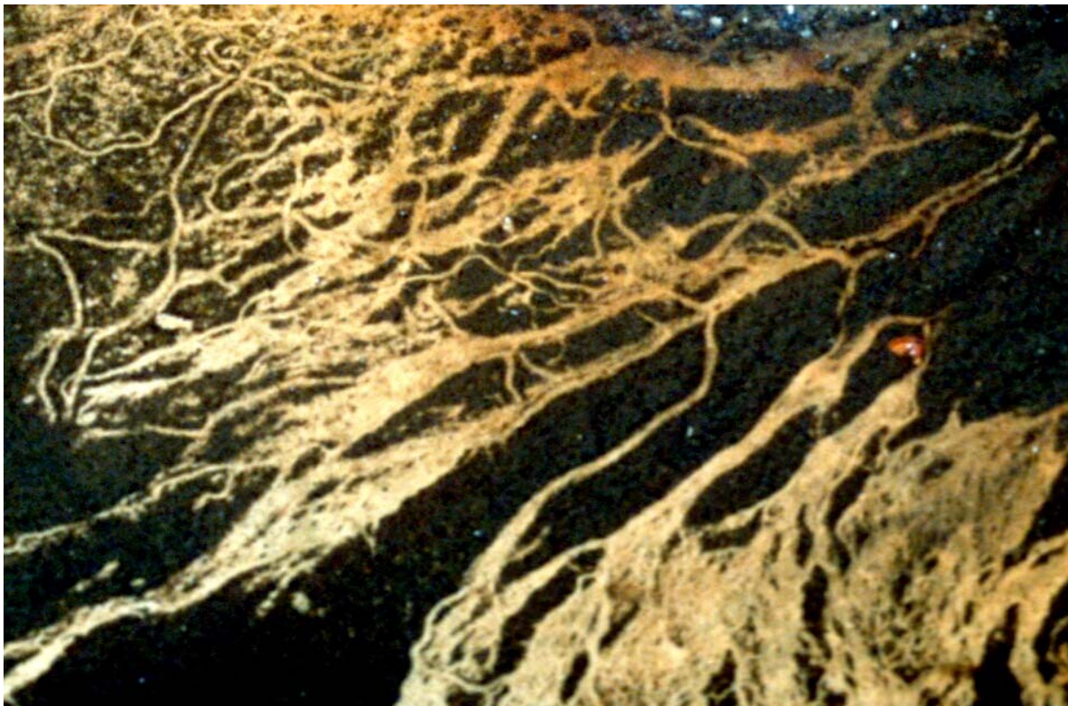
Bild 4.3.2 D: Ablagerung von Manganoxiden in einem Hochbehälter, 1993
