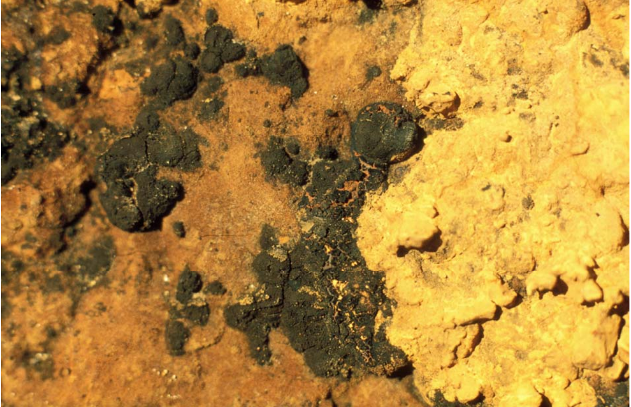
Bild 4.3.2 E: Ablagerung von Manganoxiden in einer Trinkwasser-Gussleitung DN 600, 1979, 5 x 7,5 mm
