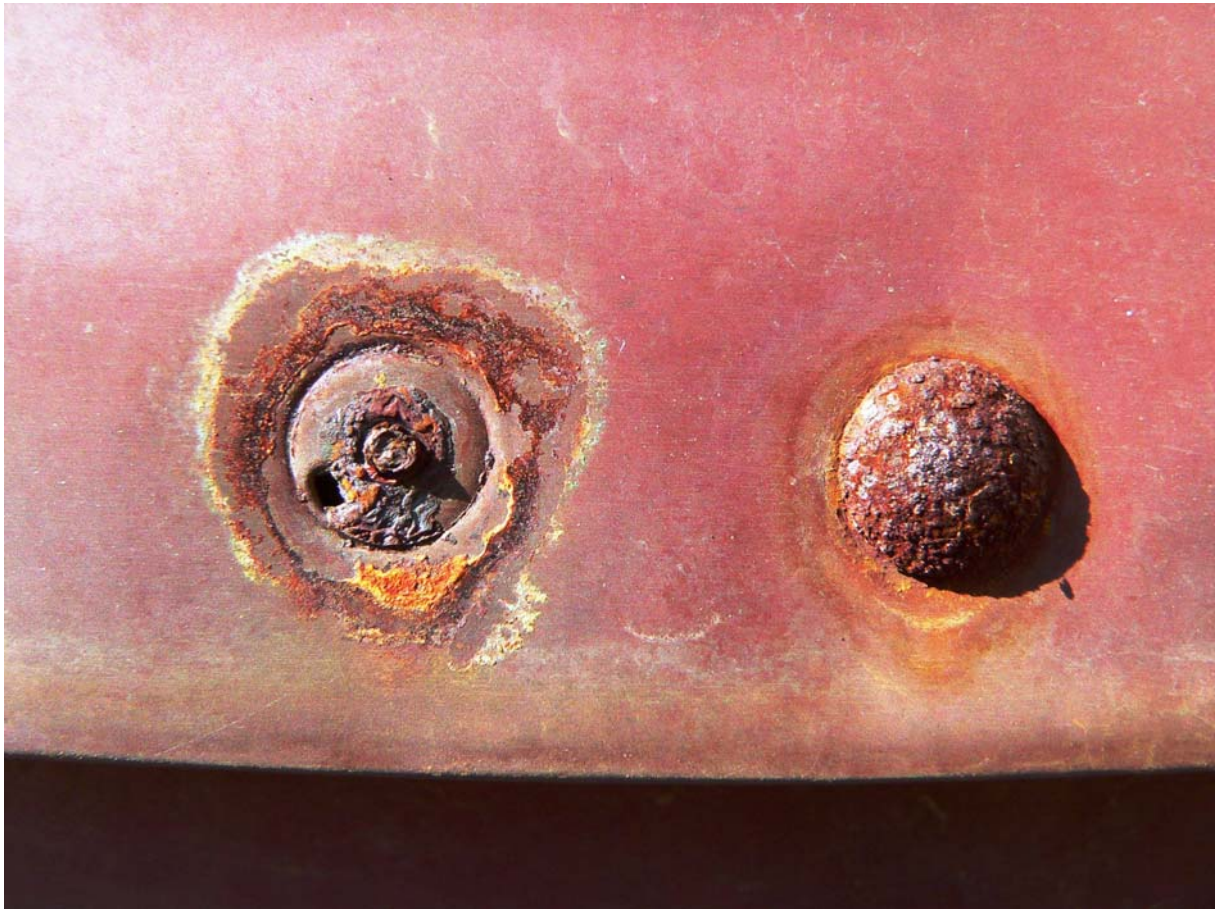
Bild 5.3.11 P: wie O, Außenseite, korrodierte Stahlnägel
