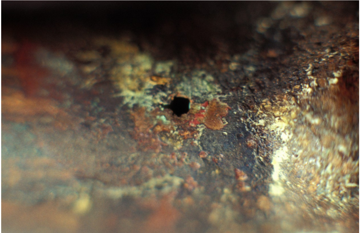
Bild 5.3.11 C: Lochkorrosion, Aufnahme von außen, Bildformat 22 x 33 mm
