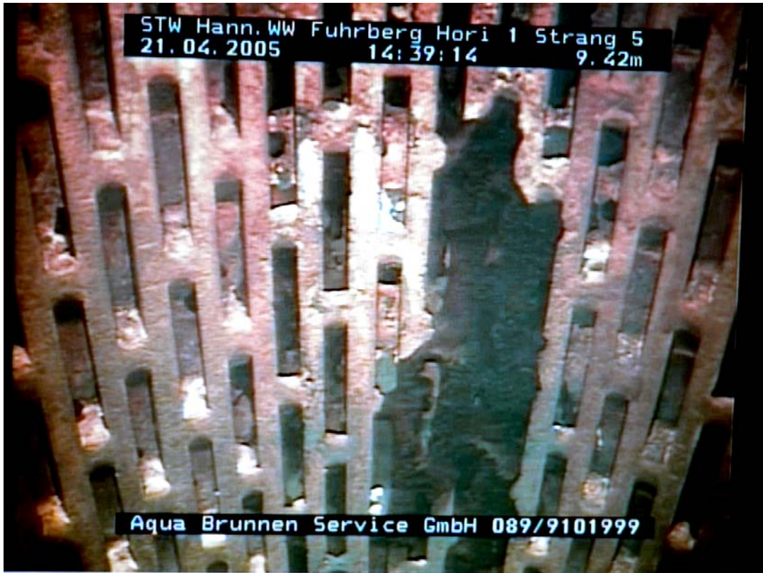
Bild 5.3.11 J: wie G, Blick auf das Brunnenfilter, Wiedergabe mit freundlicher Genehmigung durch Aqua Brunnen Service GmbH.
