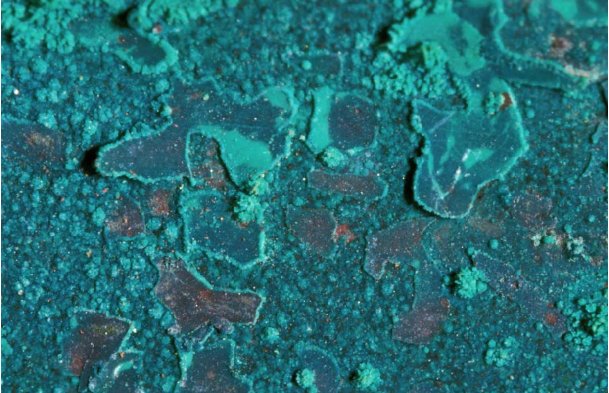
Bild 5.3.11 E: Aufgeschnittenes Rohr, Schadensfall (durch Kohlenstoffschichten verursacht?), 5 x 7,5 mm
